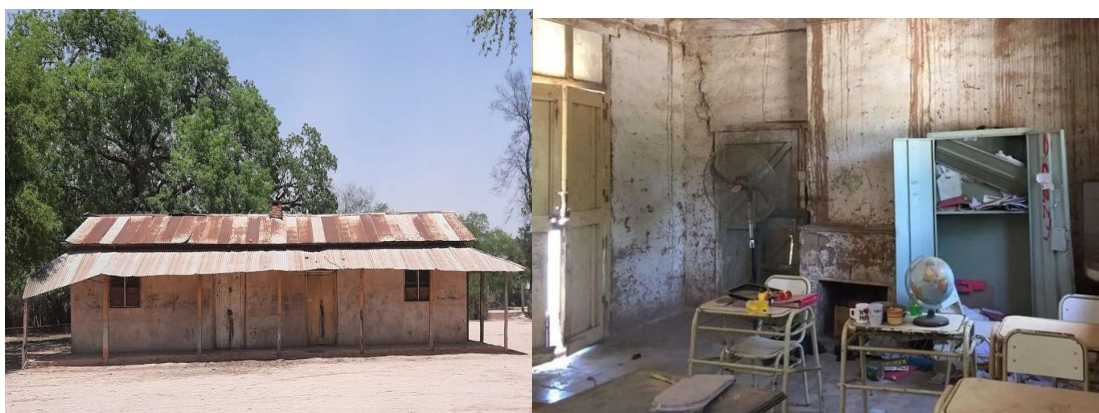
Riesgo de derrumbe
